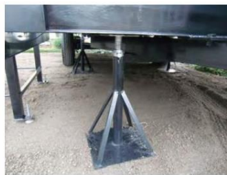
②車輪以外の物で地盤上に支持されている場合、その支持構造体が工具なしで取り外しができること。
